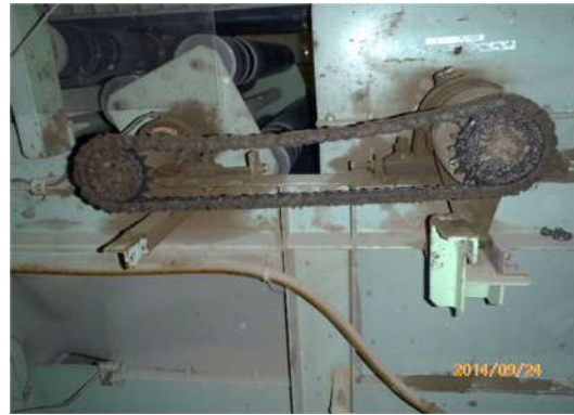
写真7 チェーンの緩みによる異音を確認
