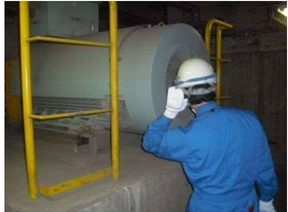
写真1 日常点検 異音の確認
