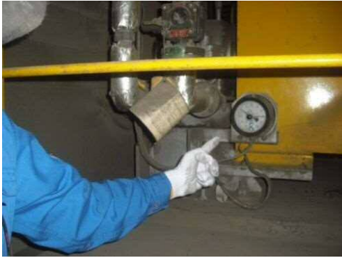
写真4 軸受け温度計日常監視
